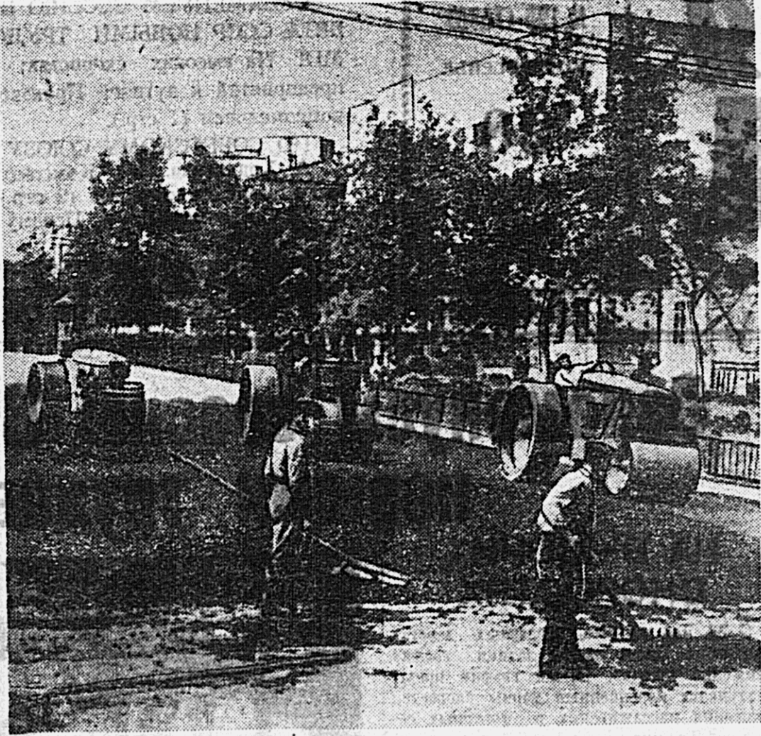
В Хабаровске ведутся большие работы по благоустройству города. Асфальтируют и озеленяют улицы, в ближайшее время закончатся строительные работы на лестнице К. Амура. На снимке: асфальтирование центральной улицы — имени Карла Маркса. Фото кинооператора В. Гулина.
